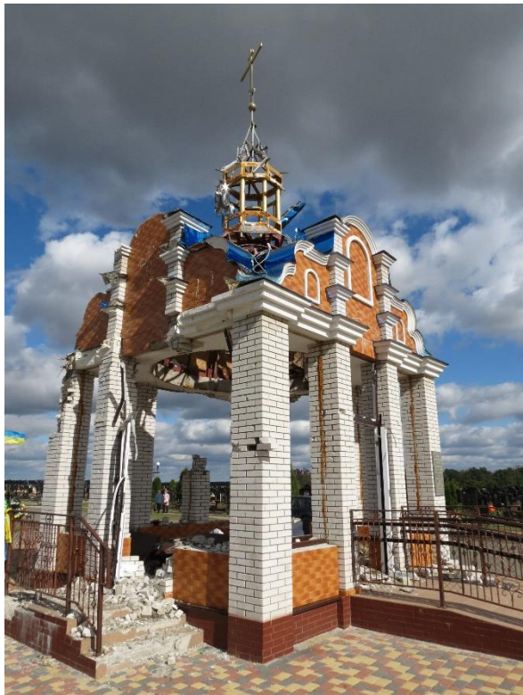
Зруйнована каплиця Архистратига Михаїла, м. Чернігів. Фото Руслана Халікова, 25 вересня 2022.
